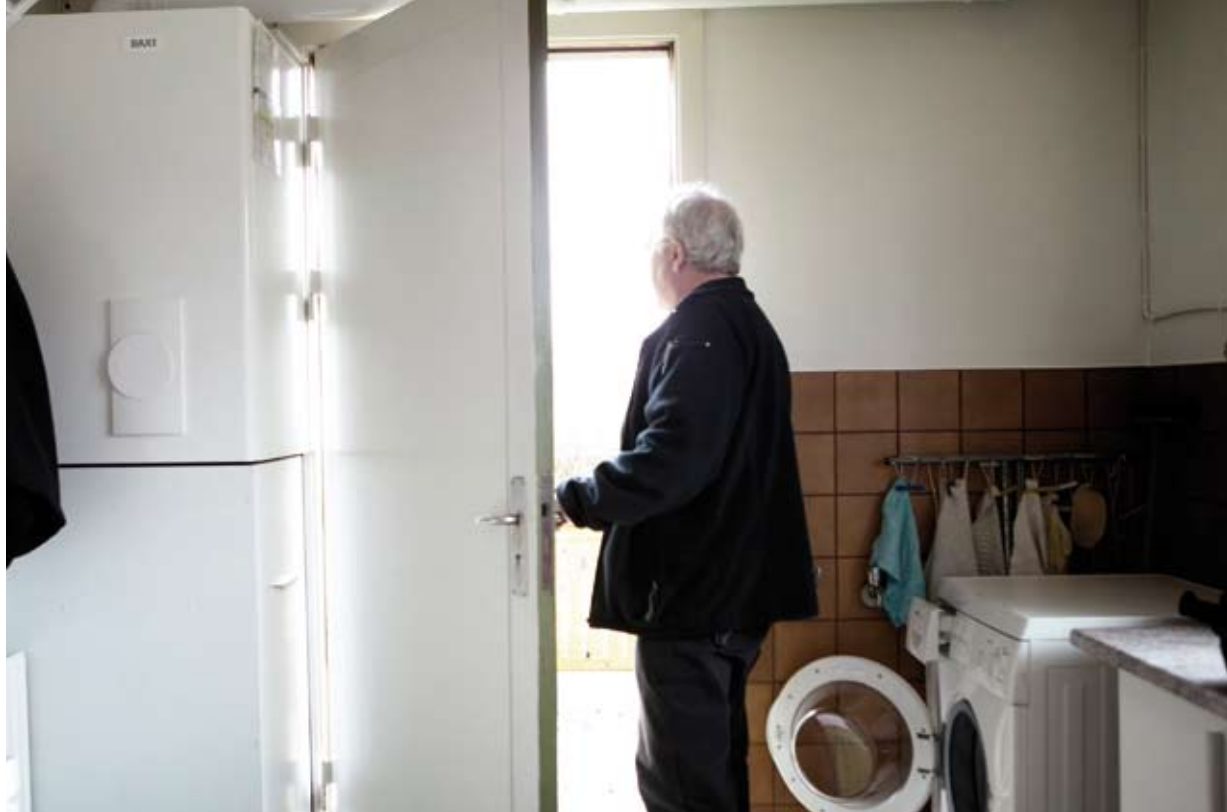
Naturgasfyret blev flyttet fra garagen og ind i bryggerset. Både det nye fyr og flytningen gav en god besparelse.
